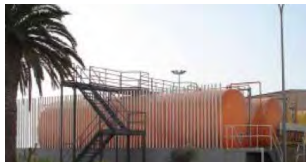
Detalle de los elementos que componen el pretratamiento: canales desarenadores (izq. arriba), filtros de arena (izq. abajo), microfiltración (centro arriba) y depósitos de almacenaje ácido sulfúrico e hipoclorito sódico (derecha).
