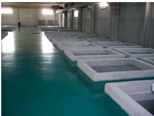
Figura 5.15: Vista de la zona de carga de los silos de calcita de una planta de calcita de flujo ascendente y altura constante.
