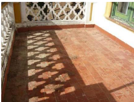
Foto 17: Mal estado de las terrazas
