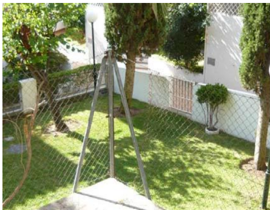
Foto 21: Vallado Perimetral Desprendido
