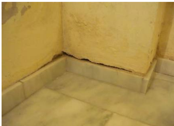
Foto 5: Grieta Sobre rodapié
