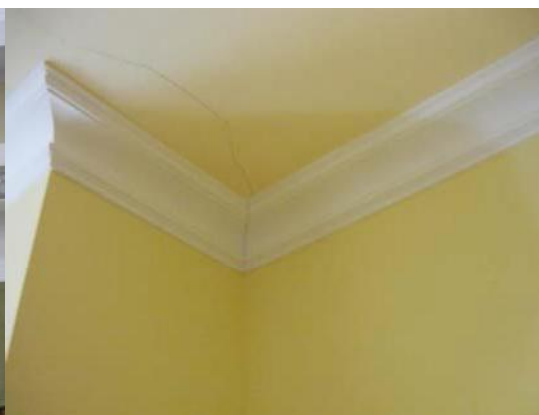
Foto 10: Techo escayola Despacho2
