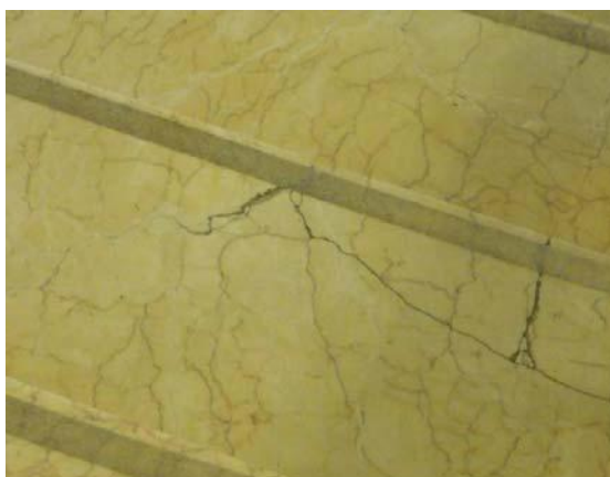
Foto 11: Fisuras en escalera ppal.
