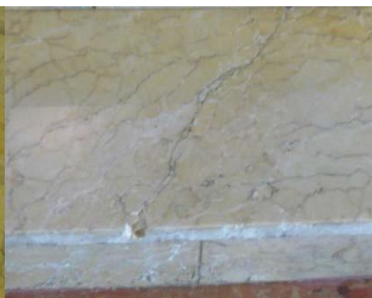
Foto 12: Fisuras en escalera ppal.
