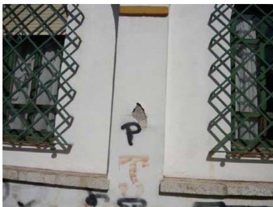
Foto 15: Deterioros y Pintadas en Fachada
