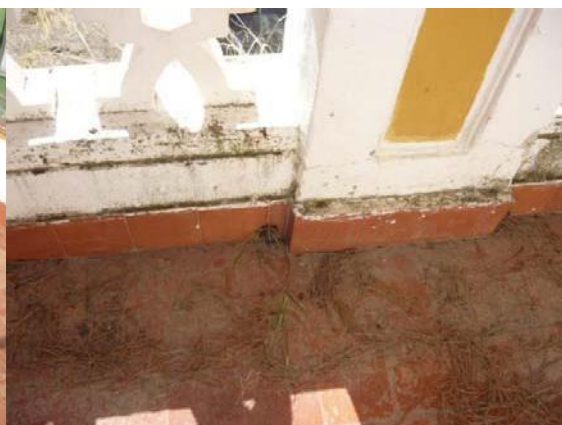
Foto 18: Obstrucción de desagües
