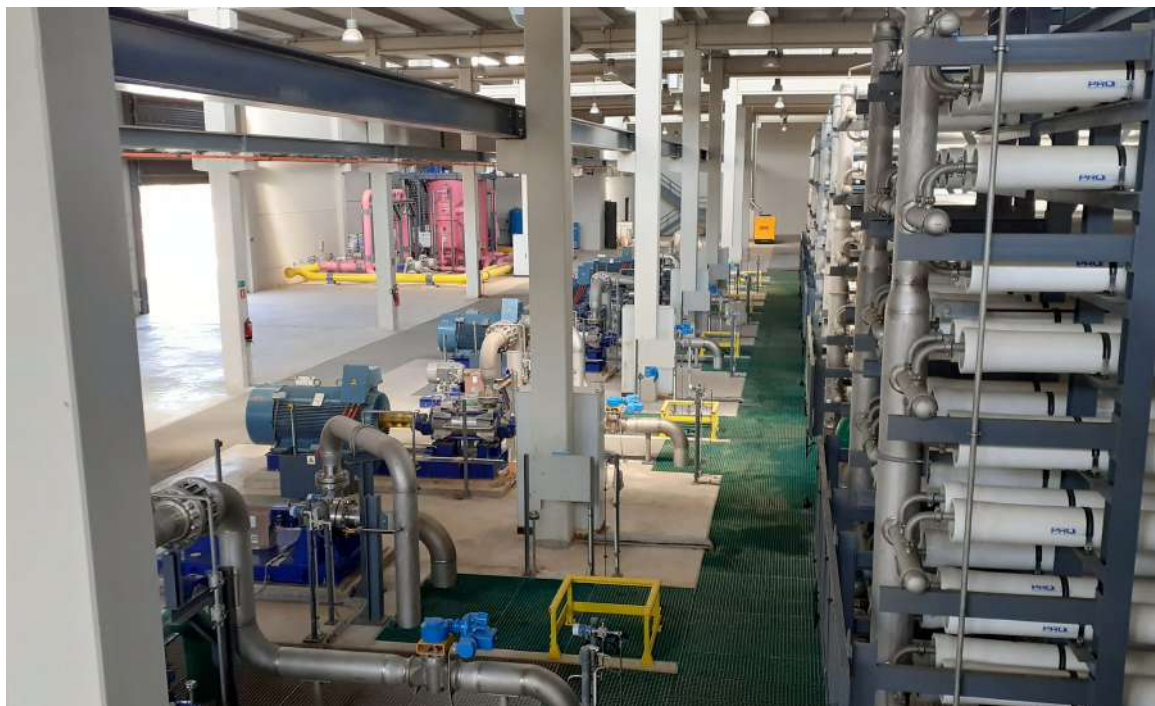
Desaladora de Oropesa
