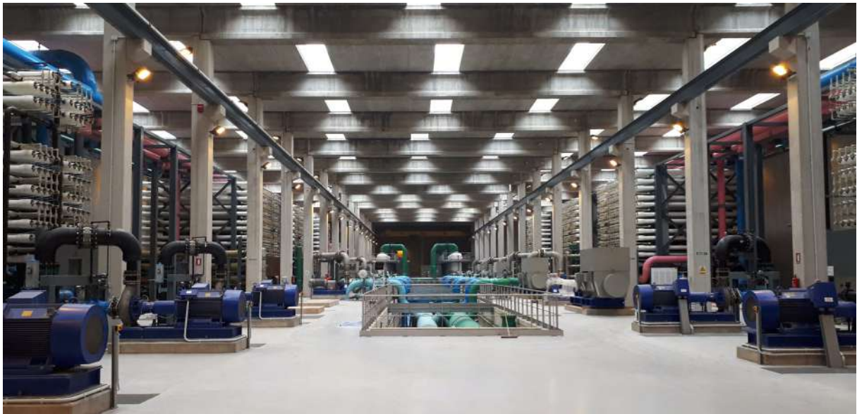
Desaladora de Campo de Dalías
