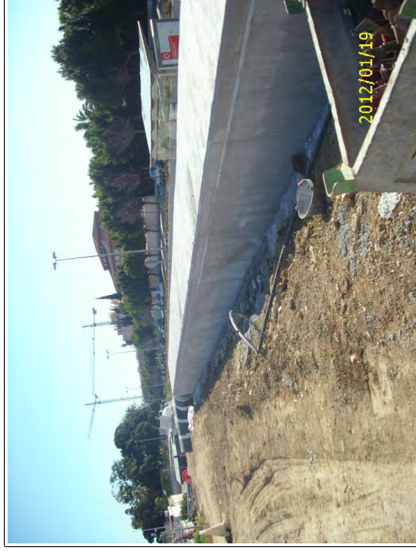
Foto 4. Tubería alojada en el interior del macizo de hormigón. ETAP de El Atabal
