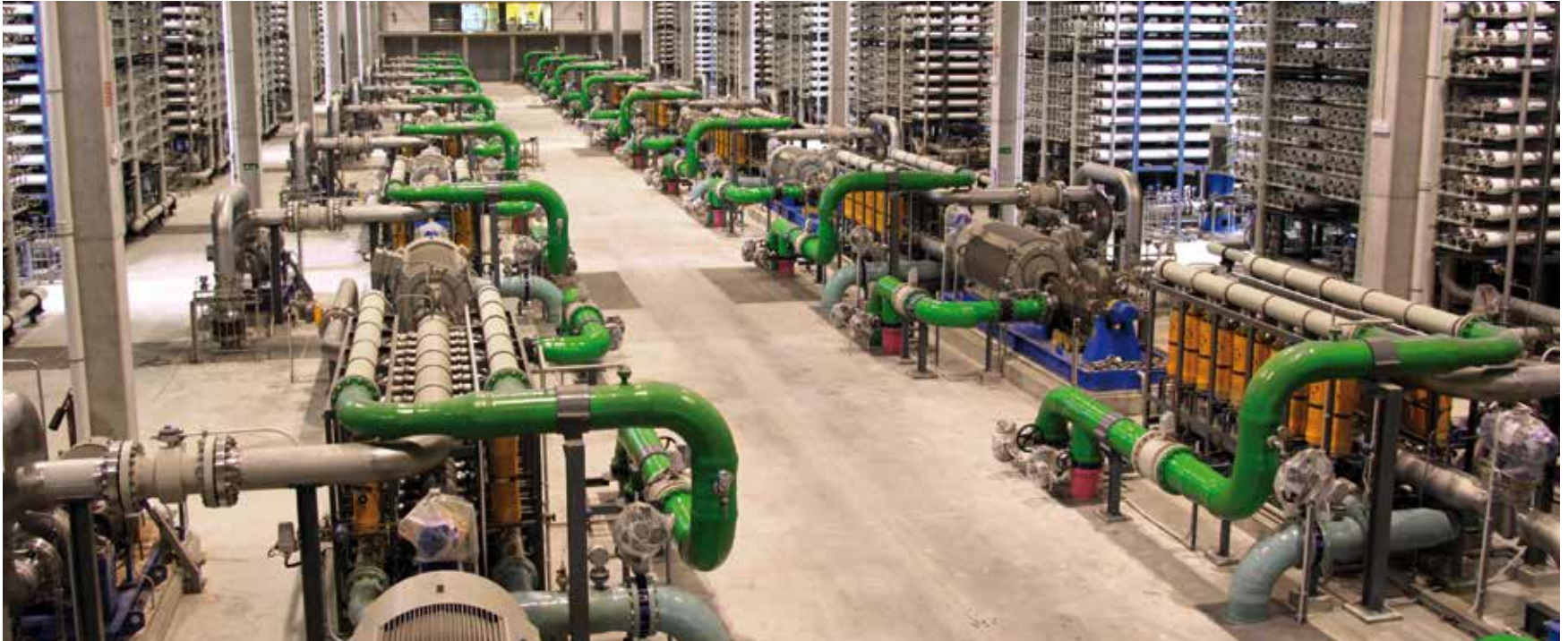
Vista general de la nave de procesos de una desaladora.
