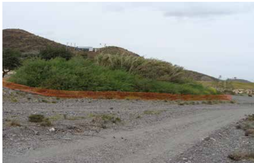
Balizamiento de áreas con vegetación no afectadas por las obras.
