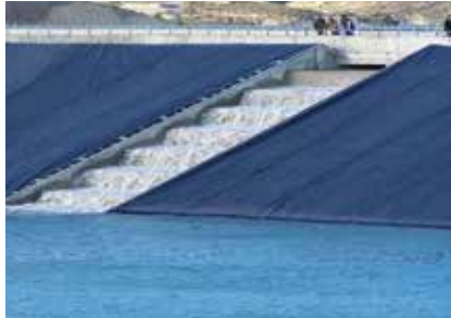
Balsa de regulación en el sistema hidráulico.
