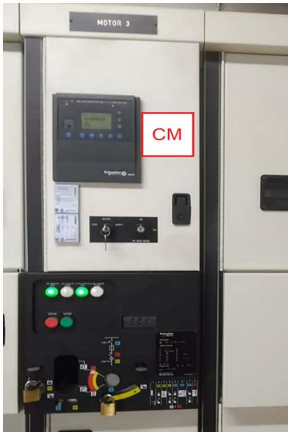
Implantación Central Medida en celda MCSet CCM bomba 6kV/ 2.800 kW
