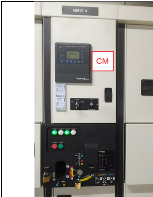
Implantación Central Medida en celda MCSet/ Motorpac del CCM bombas 6kV/ 2.800 kW
