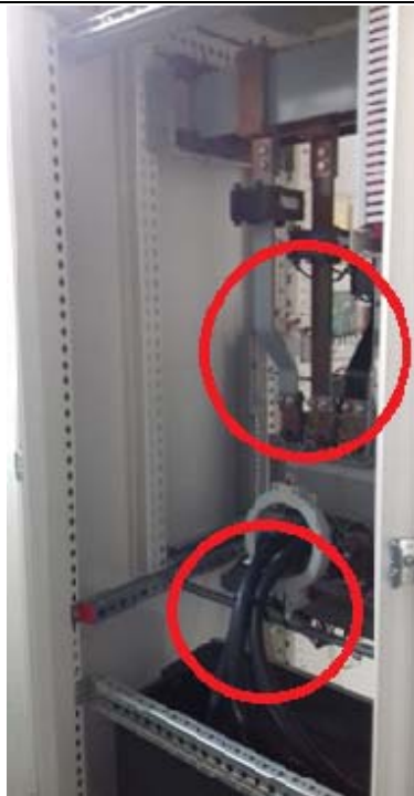
Interior armario alimentación bomba EB La Marquesa, vista posterior, izquierda Posible montaje de transformadores de corriente
