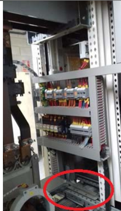
Interior armario alimentación bomba EB La Marquesa, vista posterior, derecha Posible montaje de transformadores de tensión
