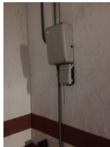
Foto 7.- Control puerta automática garaje
