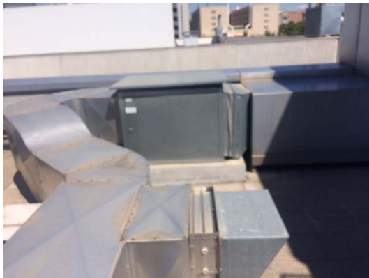
Foto 17.-Conductos de extracción y extractor general del edificio
