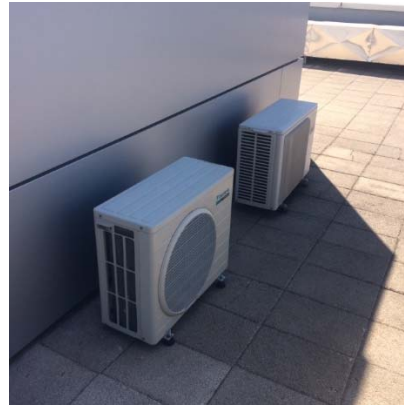
Foto 22.-Equipos de frio de sala informática
