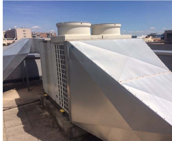
Foto 16.-Recuperador de calor (actualmente sin uso)
