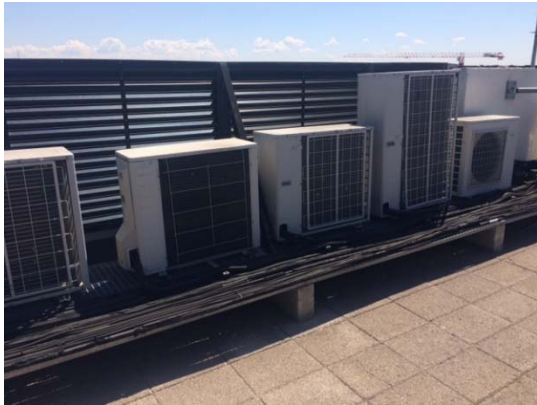
Foto 21.-Equipos de frio del edificio
