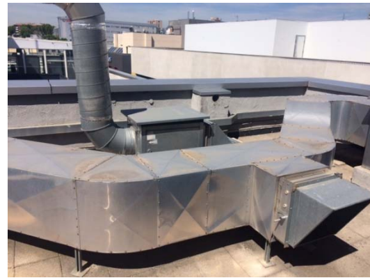
Foto 18.-Conductos de extracción y extractor aseos
