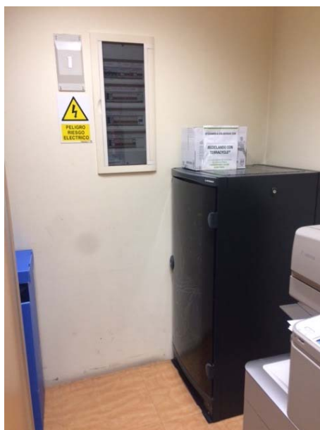
Foto 13.-Cuadro eléctrico planta y rack de apoyo por planta
