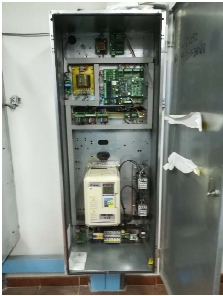
Foto 27.-Cuadro de Maquinaria
