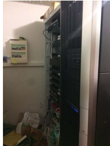
Foto 24.-Sala informática (2 racks)
